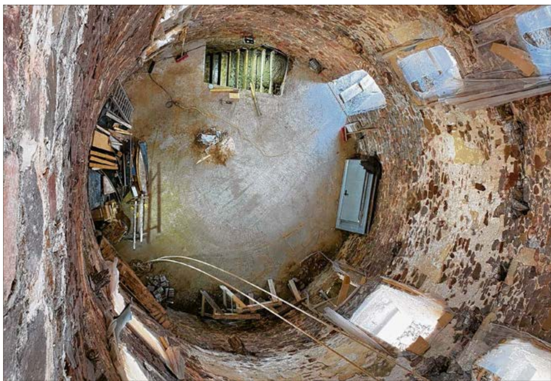
Blick in das Innere der Mühle aus der obersten Etage in Richtung Fußboden.
